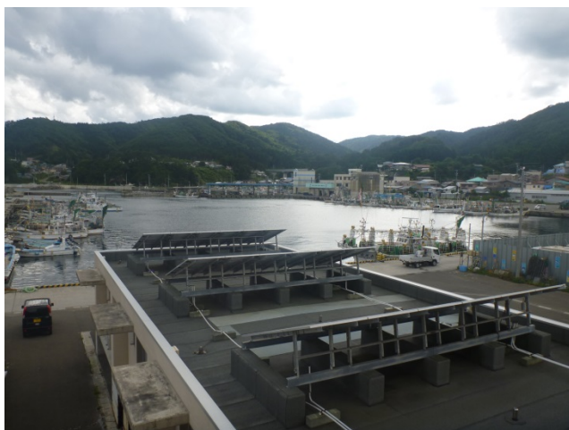
写真 3.1-2 太陽光発電施設と泊地
