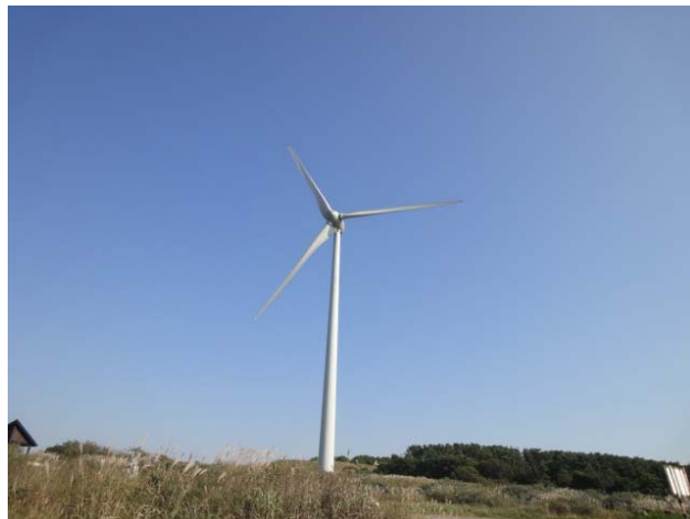
図 2-1-5 プロペラ式風力発電施設の例（秋田県秋田市雄物川河口部）
