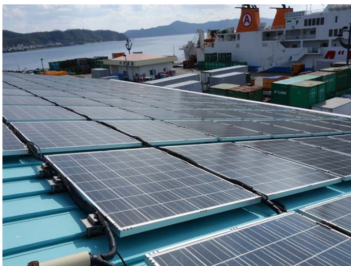
写真 3.1-8 傾斜屋根に設置された太陽光パネル
