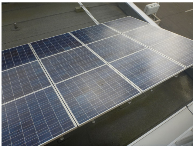
写真 3.1-3 太陽光発電施設
