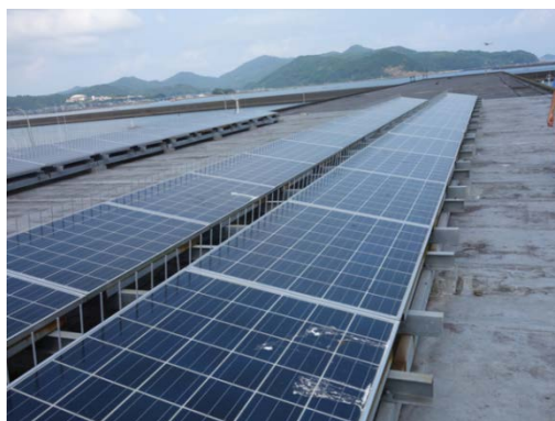
写真 2.4-8 太陽光パネル（パネル上の糞害）
