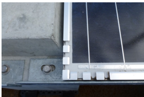
写真 2.4-7 水切り用溝のついた太陽光パネル
