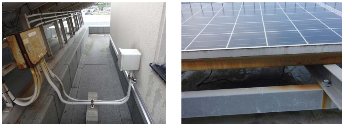
写真 2.4-5 漁港区域に導入された太陽光発電の塩害の事例 (左：接続箱の錆び、右：架台の錆び)
