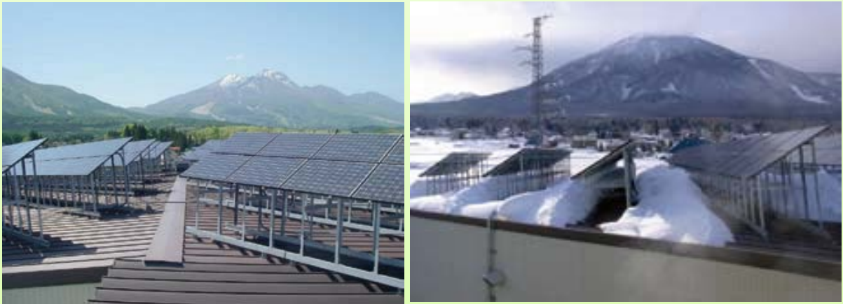
写真 2.4-4 積雪地域の工場での太陽光パネルの設置事例（左：積雪なし、右：積雪時）
