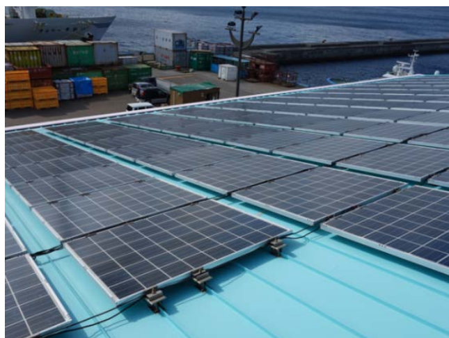
写真 2.4-1 古仁屋漁港（傾斜屋根の例） 海の駅屋根面に設置（27.5kW）
