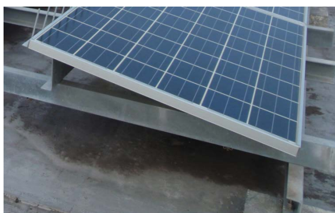
写真 2.4-6 塩害対策例（溶融亜鉛めっき架台の例）
