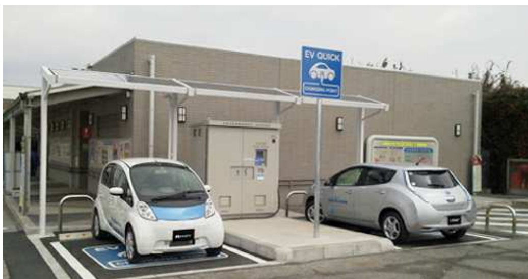
図 26 「創エネ」 & 「蓄エネ」 型 EV 用急速充電 吹田 SA システム
